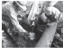
劣化状況評価等
