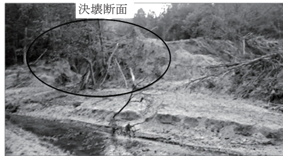
(b) 勾配 10° 未満のため池 図-3 被災ため池の写真
