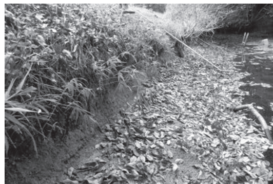
写真2 老朽度Aのため池
